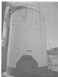
Foto 1. Tanque de almacenamiento de aguas residuales sin dique de contención.
